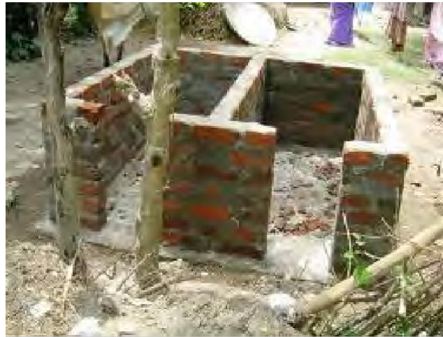
Double Chamber brick UDDT Toilet Base
