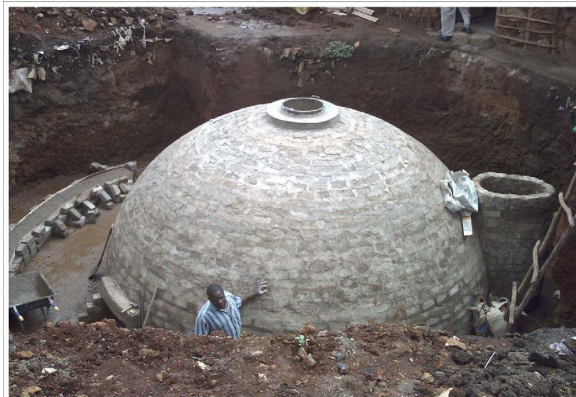
Digestor de biogás sendo construído pela Umunde Trust, em Nairóbi. Um centro biológico é construído sobre um digestor, com banheiros públicos no andar térreo e cozinha, escritório e sala de reunião no primeiro andar. Combustível para geração de energia e uso na cozinha é diretamente derivado dos gases gerados das urinas e fezes coletados nos banheiros públicos e armazenados na câmara de expansão.
